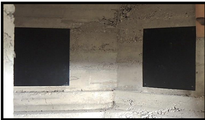
Figure 8 : Obstruction complète des petites ouvertures côté route (intérieur) - ©A. Cartier
