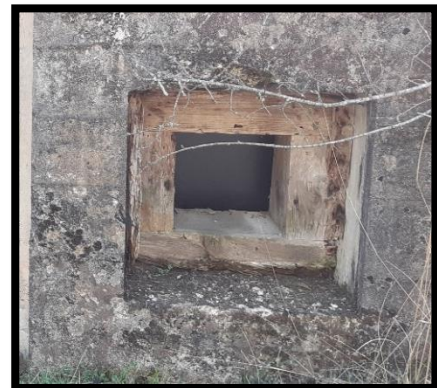
Figure 4 : Obstruction complète des petites ouvertures côté route (extérieur) - ©E. Burlotte
